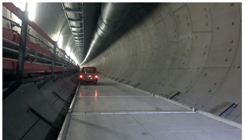
Abb. 5: Die Ausweichen aus Stahl im Tübbingtunnel wurden für den Begegnungsverkehr und Arbeiten an den Querschlägen eingebaut
