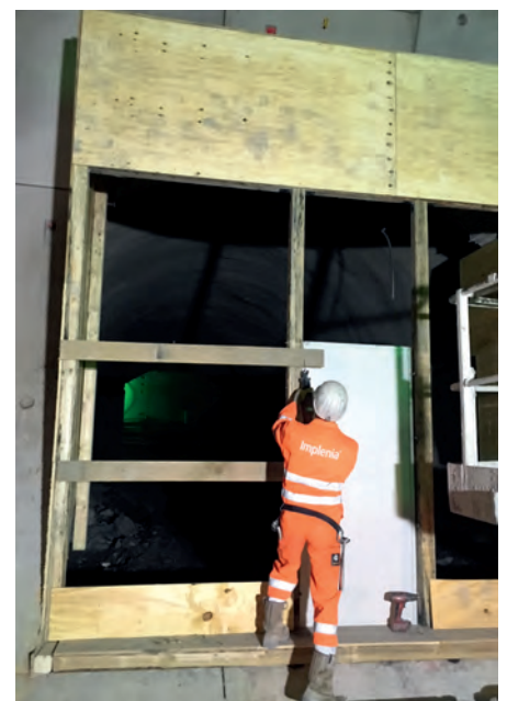
Abb. 7: Rauchschotts an den Verbindungsbauwerken sollen verhindern, dass Rauch in die benachbarte, als sicher geltende Tunnelröhre gelangt
